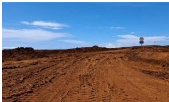
Gambar 4 Segmen 2 jalan bergelombang
